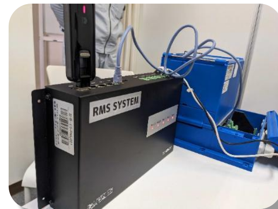
2. で特定可能となった該当機器 (手前が上流ルータ、奥が流量計本体)
